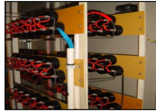
Rectifier Bank Assembly
