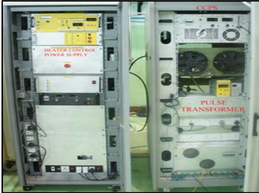
90 kV solid state pulse modulator assembly 90 kV ठोस अवस्था पल्स मॉड्यूलटर असेंबली
